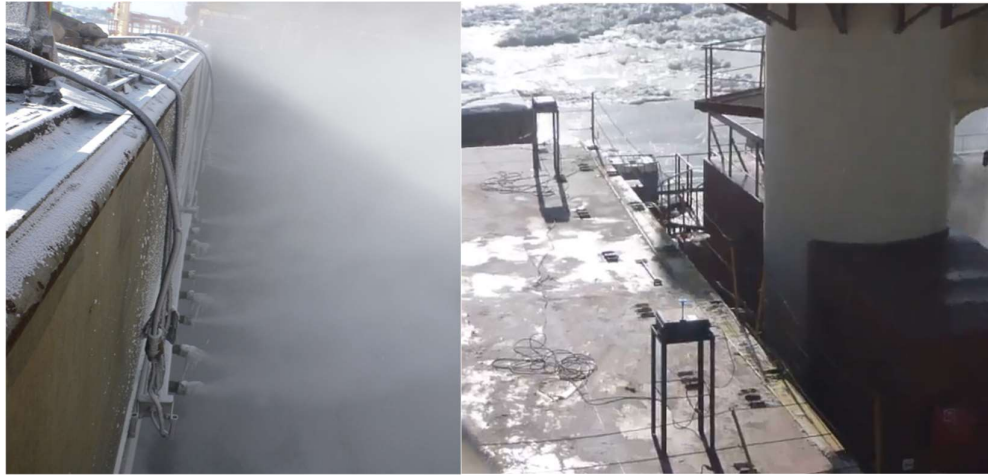
Figure 5 – Système de brumisation (image de gauche) et détecteurs de poussières (image de droite) sur le navire Arvik I
